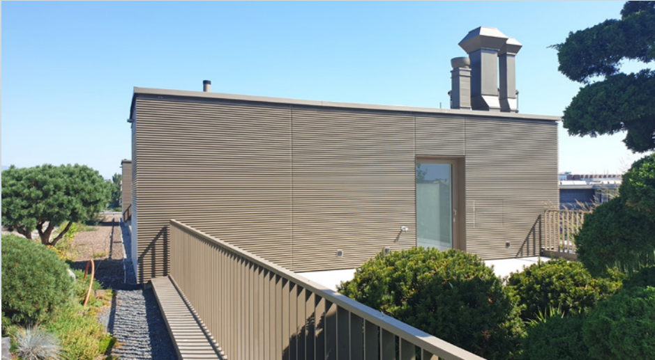
Bei den isolierten Dachaufbauten kamen Volllamellen vom Typ DucoWall Solid 30 Z zur Anwendung. Des lamelles pleines du type DucoWall Solid 30 Z ont été utilisées pour les structures de toit isolées.
